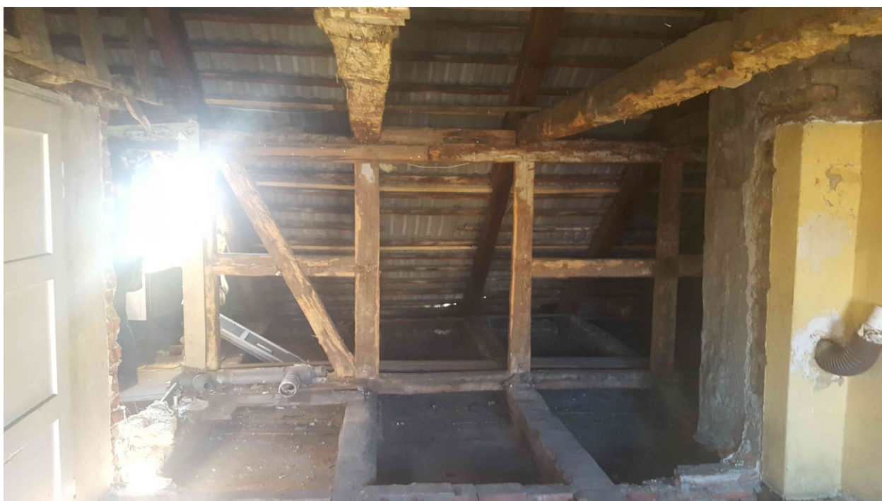
Fot. 4 Elementy więźby zaatakowane przez spuszczała – dach główny
